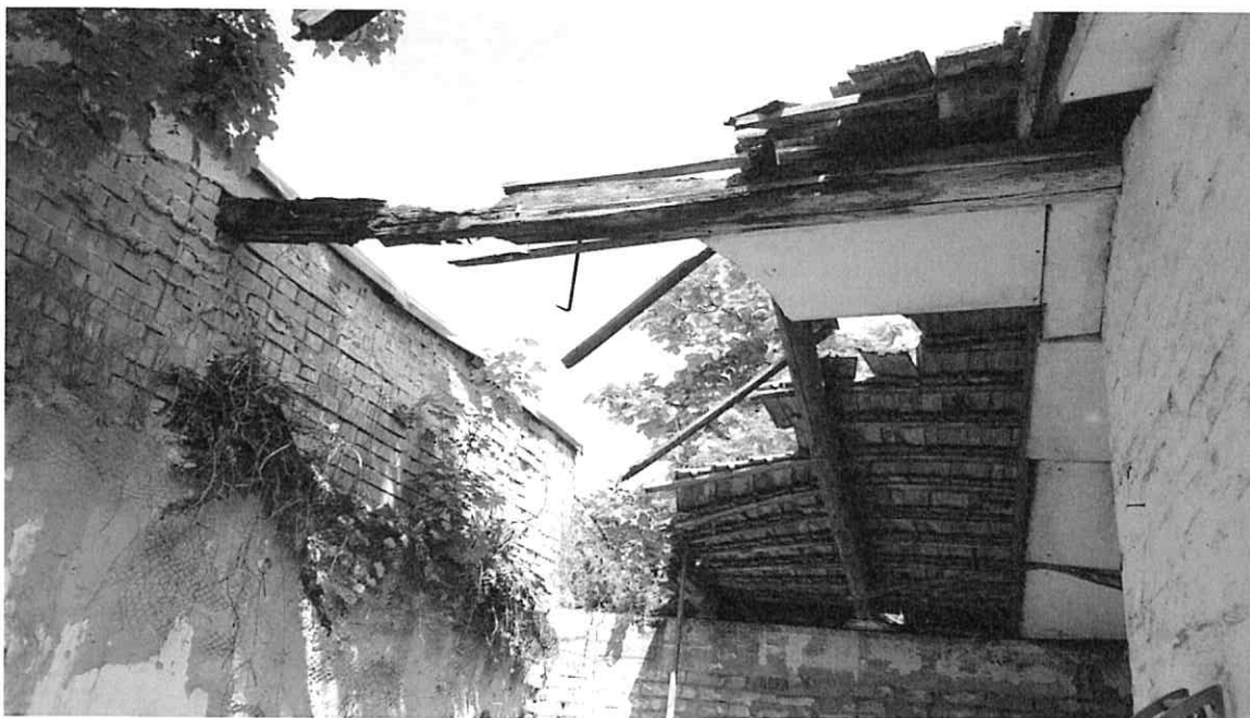
Az szárny utolsó része, leszakadt földém és tető.
